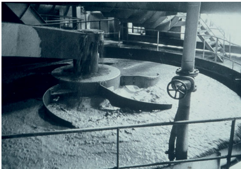
Рис. 3. Круглые отсадочные машины устаревшей конструкции
